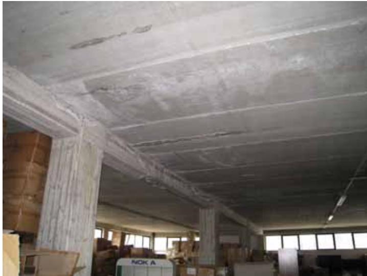
FOTO n° 19: Vista interna locale magazzino piano terra e macchie d'umidità.
