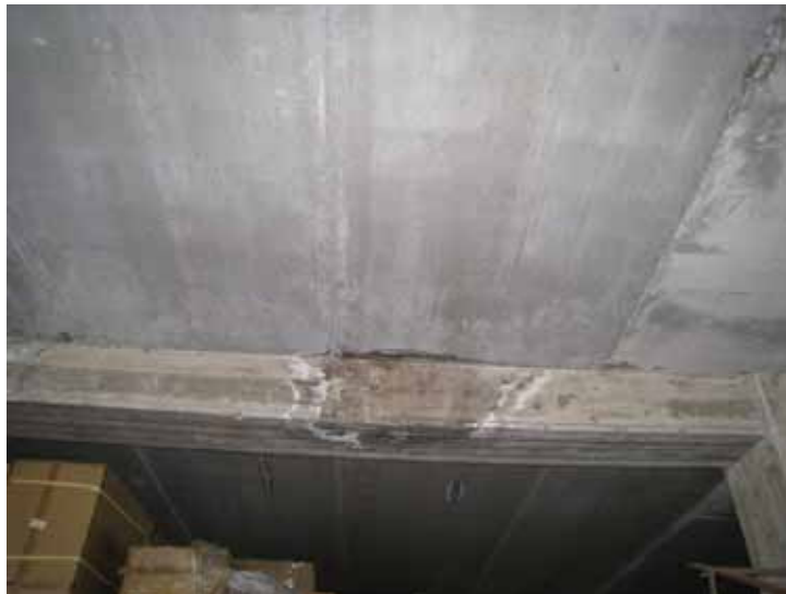
FOTO n° 17: Vista interna particolare macchie d'umidità al piano terra.
