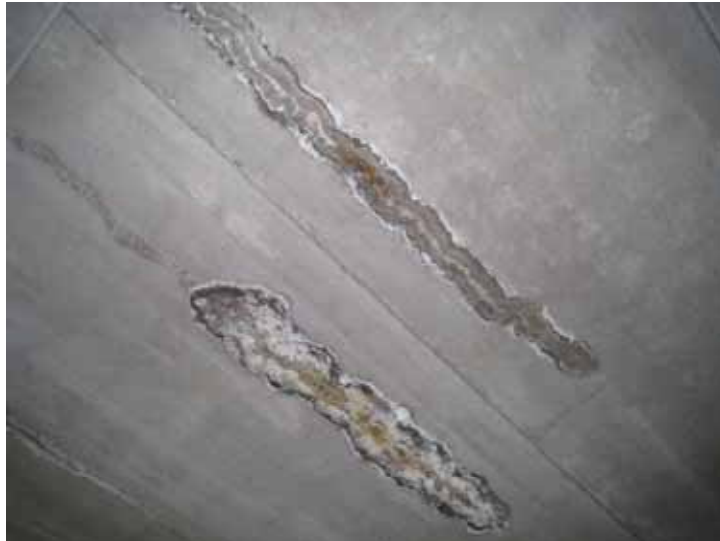
FOTO n° 16: Vista interna particolare macchie d'umidità al piano terra.
