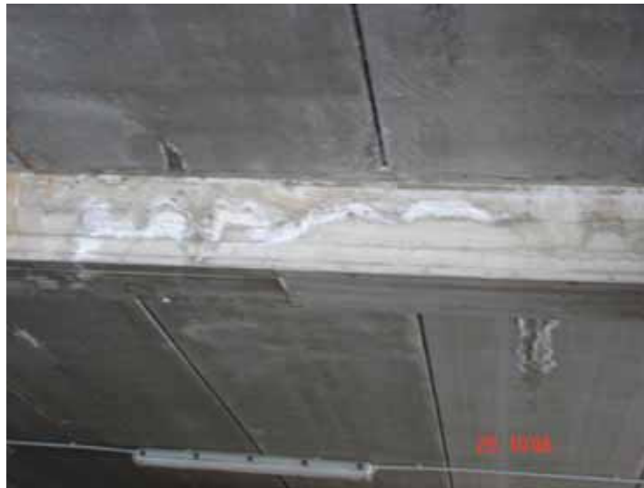
FOTO n° 26: Particolare ammaloramenti strutture di copertura piano terra.
