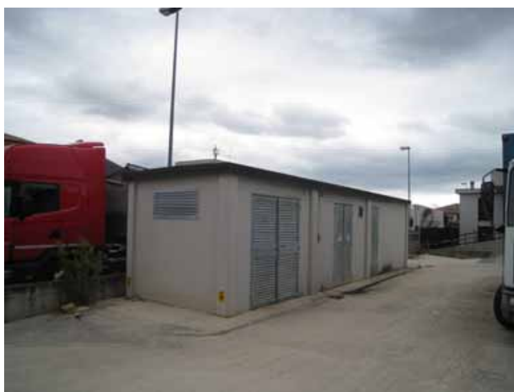
FOTO n° 6: Vista locali tecnologici lato Nord.
