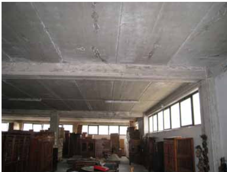
FOTO n° 15: Vista interna locale magazzino piano terra e macchie d'umidità.
