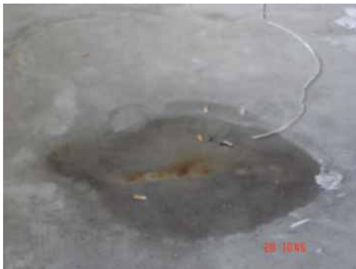
FOTO n° 28: Particolare infiltrazioni d'acqua al piano terra.
