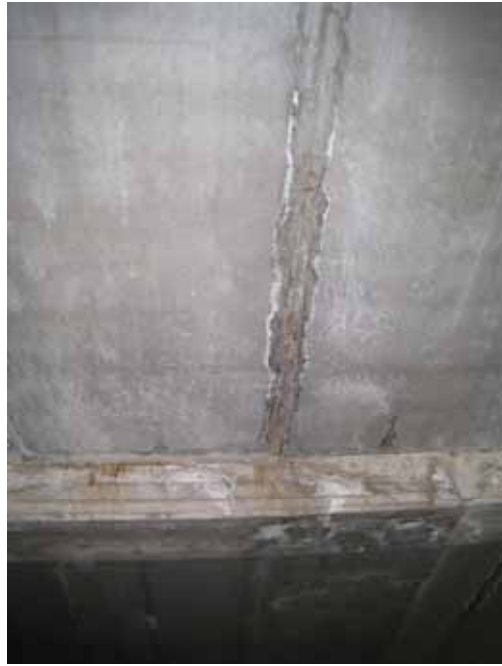
FOTO n° 22: Vista interna particolare macchie d'umidità al piano terra.
