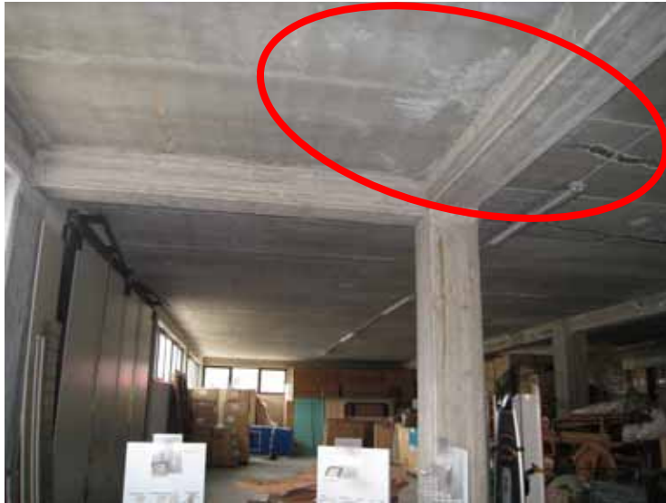
FOTO n° 13: Vista interna locale magazzino piano terra e macchie d'umidità.
