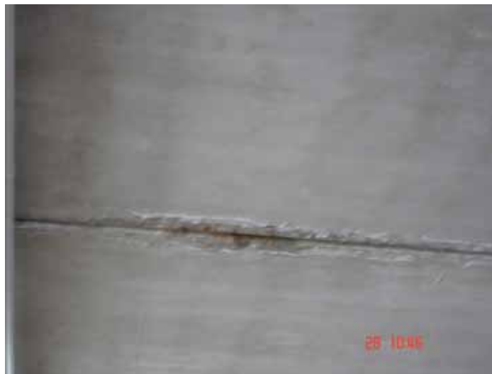
FOTO n° 27: Particolare infiltrazioni d'acqua al piano terra.
