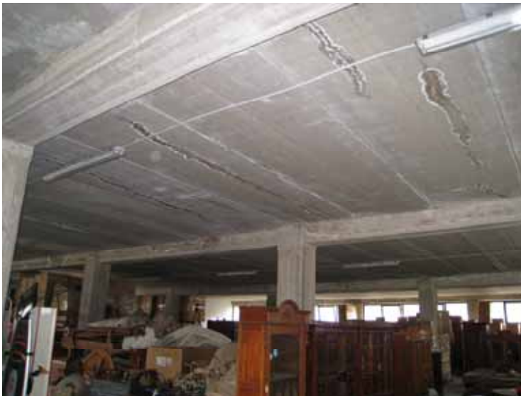
FOTO n° 14: Vista interna locale magazzino piano terra e macchie d'umidità.
