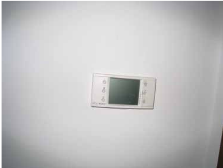
FOTO n° 19: Particolare termostato appartamento.
