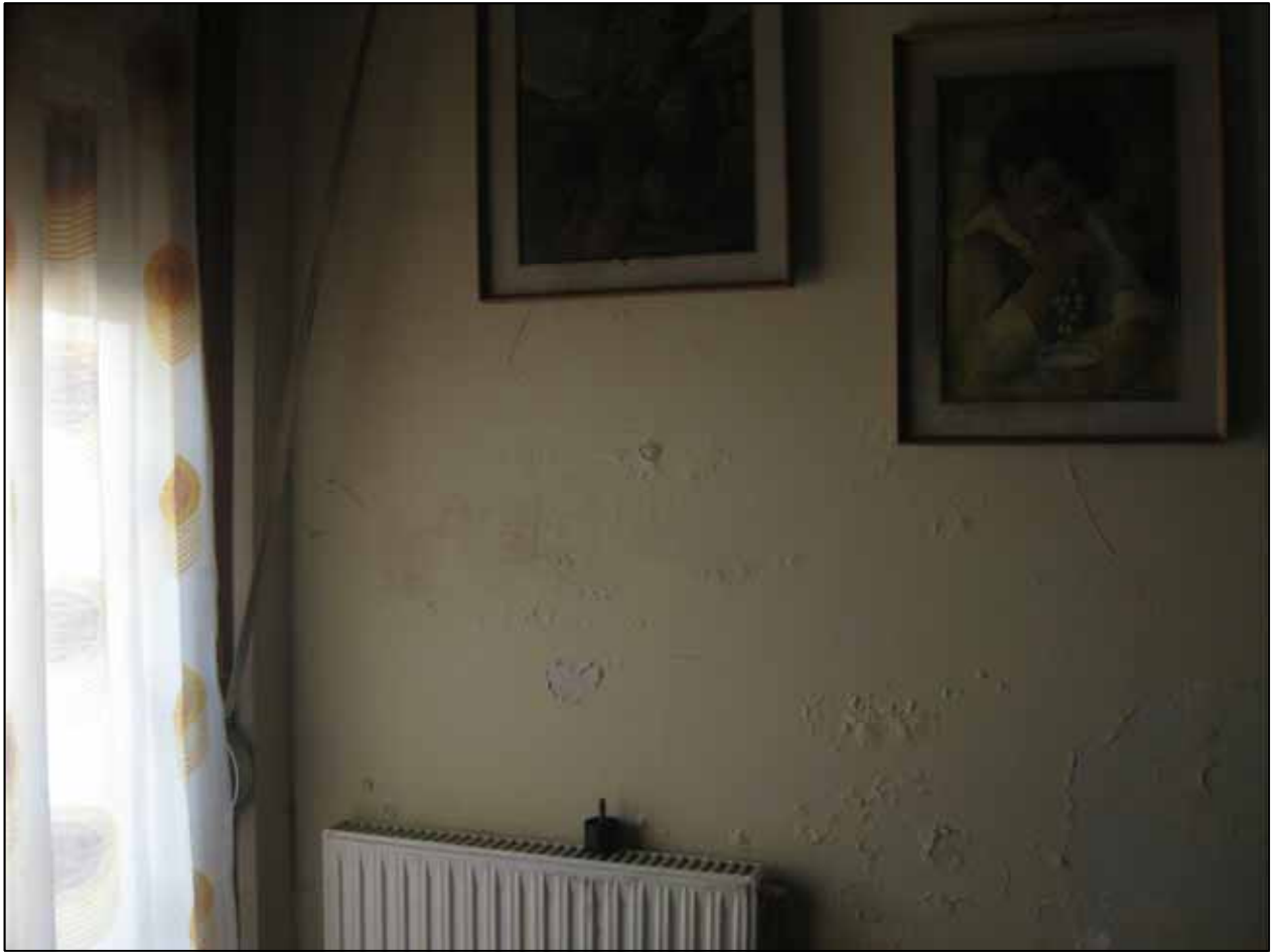
Presenza zone di umidità
